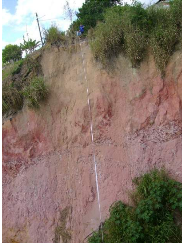
Figura 05. Perfil do Argissolo no talude da voçoroca.
